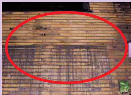
使用前 看板を外した跡の排煙の油・複合汚染の汚れ。
