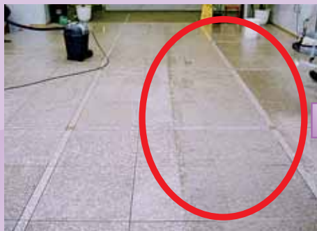
使用前 養生テープの跡が残っています。
