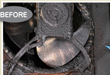
換気扇の汚れ
