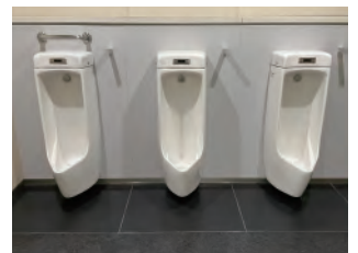
■ 小便器の汚垂石(お立ち台)
